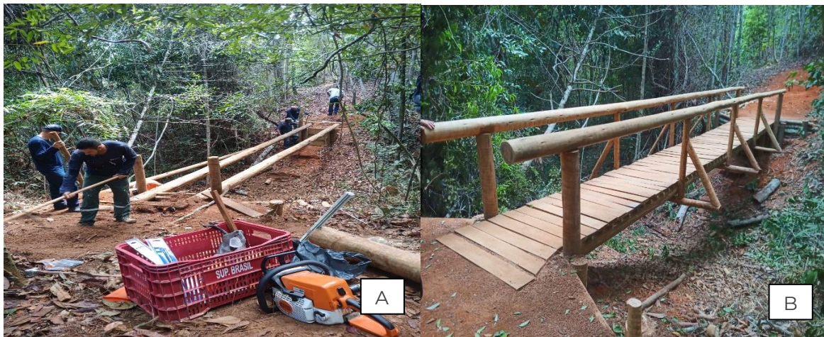
Figura 43. Trilha Interpretativa Angico Vermelho A) B) Construção de uma passarela com madeira de eucalipto tratado. Comprimento de dez metros em área em declive acentuado.
