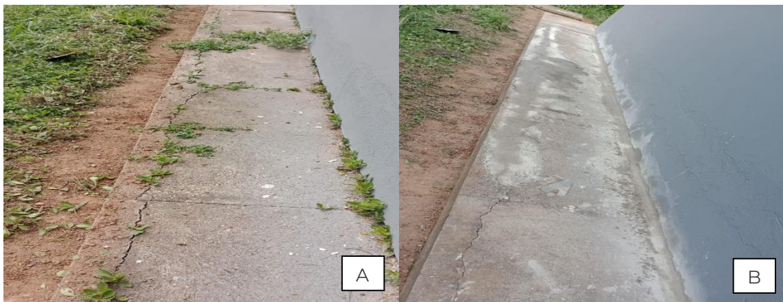
Figura 29. Alojamentos do Centro de Pesquisa A) B) Reparos com areia e cimento nas calçadas no entorno de toda estrutura.
