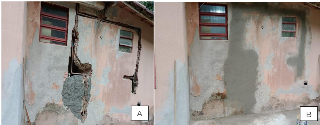
Figura 30. Casa das Flores A) B) Manutenções de todas as partes hidráulicas. Reparos finalizados com areia, cal e cimento nas paredes da estrutura.
