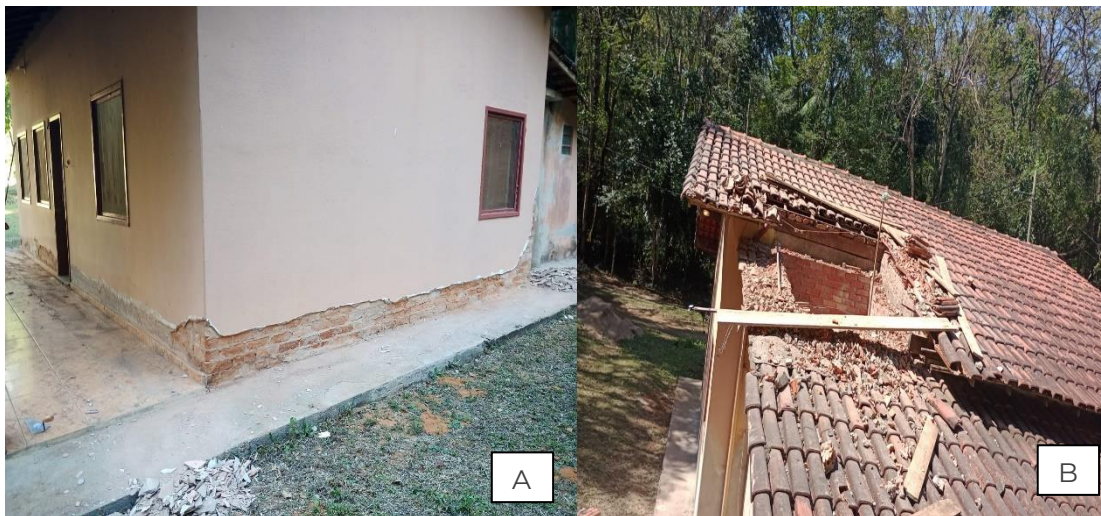
Figura 19. Casa das Flores A) B) Início das manutenções mistas, com retiradas de rebocos estourados, hidráulicas e telhados.
