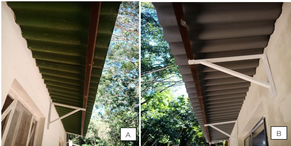
Figura 38. Herbário e Laboratório A) B) Limpeza e pintura com três demão de tinta extra cinza escuro em toda área externa do beiral do telhado das estruturas.
